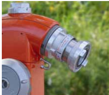
Systemtrenner am Überflurhydrant
